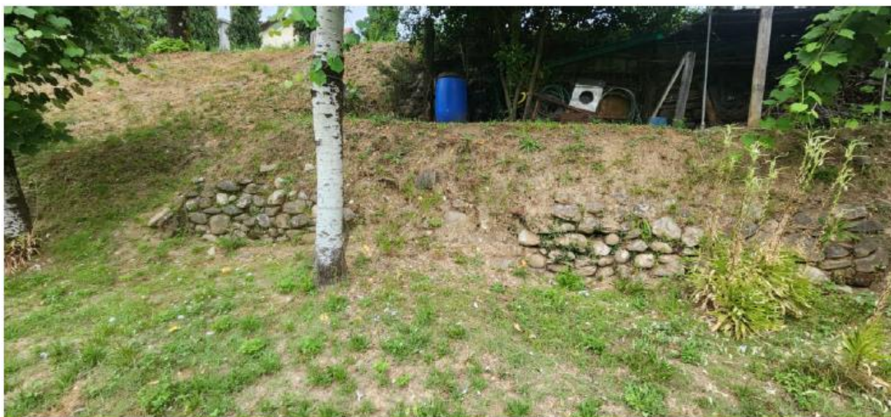
Figura 2: vista del tratto di muro ad Est, da osservare che il muro è in parte crollato
