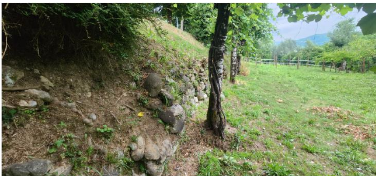
Figura 3: vista laterale del muro a secco in stato di degrado con tratti crollati e perdita di verticalità
