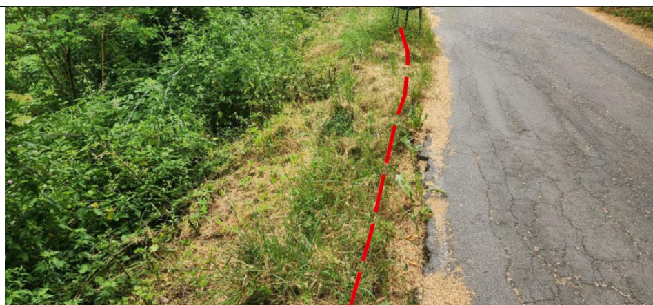
Figura 3: vista parte apicale dissesto caratterizzato da una lesione continua del terreno accompagnata da cedimento dello stesso sul lato valle
