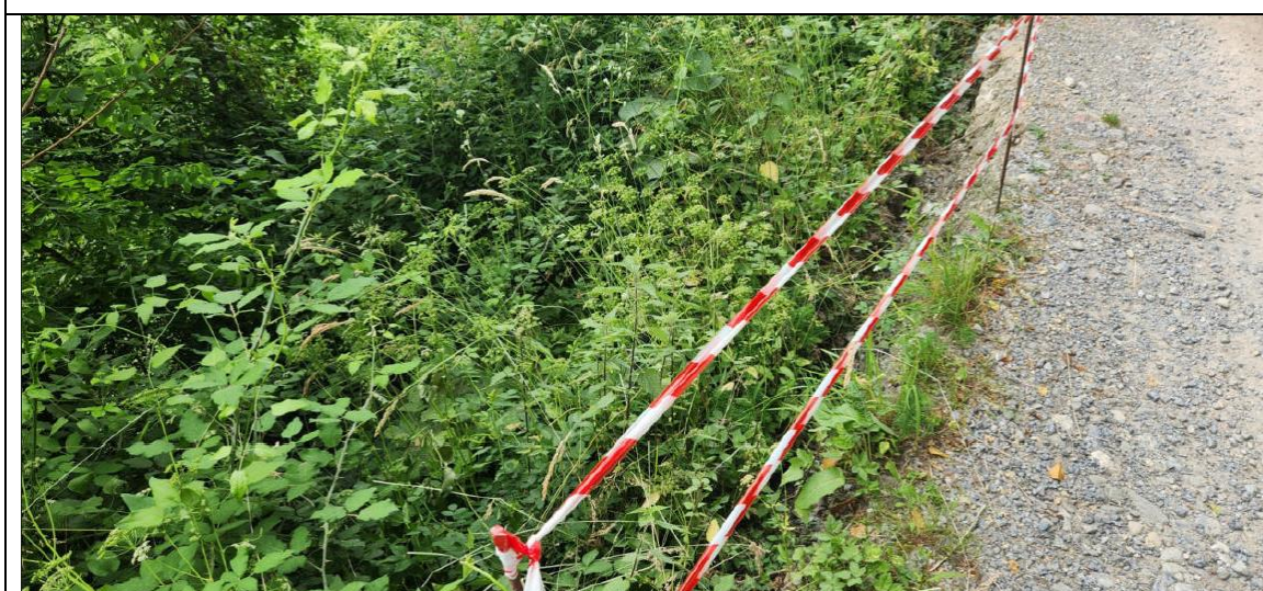
Figura 3: vista dettaglio dell'apice dell'area dissestata caratterizzata da un cedimento continuo dell'ordine di decimetri
